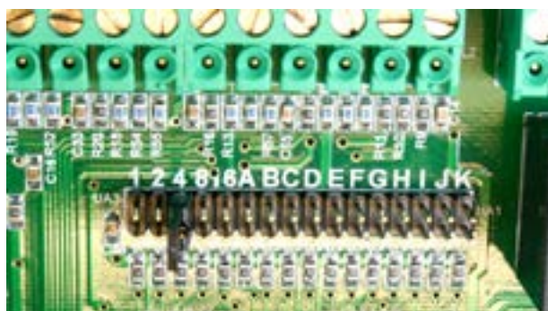
Bild där adress 4 är inställd.
